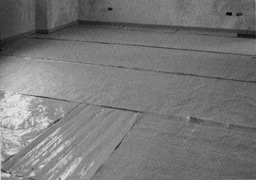
Particolare di posa dello strato separatore anticalpestio KoSep.F completo di strisce in sughero supercompresso KoFlex lungo il perimetro del locale sopra l'impasto di SugheroLite + KoGlass.
